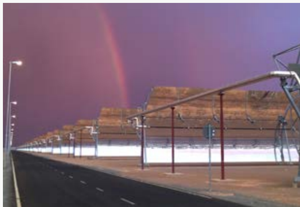
► Vista parcial del campo solar de Xina Solar One con colector cilindroparabólico de gran apertura.
