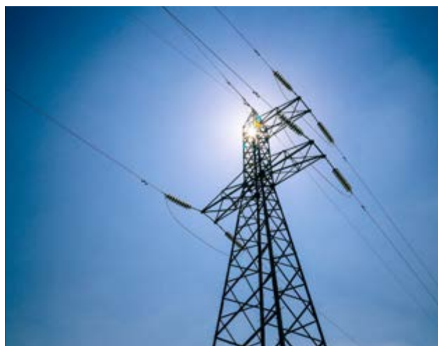
► Abengoa es un referente internacional en transmisión y distribución con más de 27.000 km de líneas y más de 330 subestaciones construidas en los últimos 15 años.
