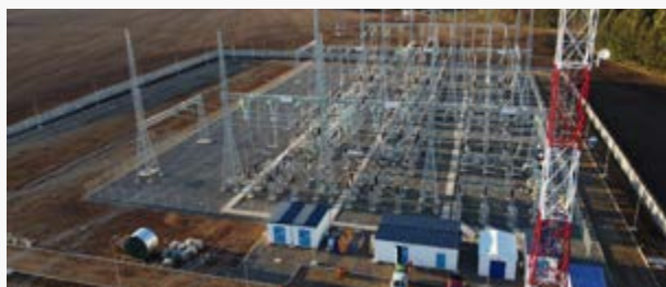
► Durante el pasado año, Abengoa concluyó la construcción de la subestación Malleco de 220 kV.
