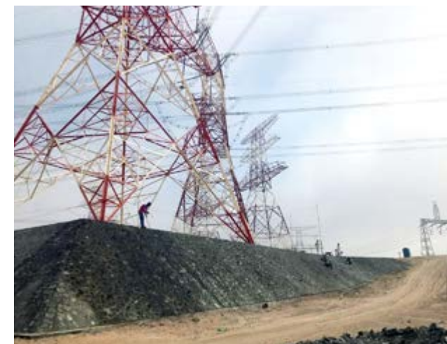
► Abengoa trabaja en varios proyectos de transmisión y distribución para el operador de alta tensión de Abu Dhabi, Transco.
