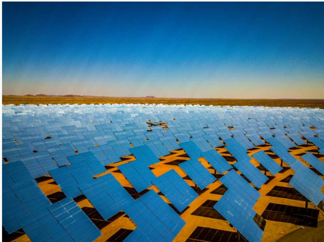
► Vista del campo solar de la planta de torre Khi Solar One.
