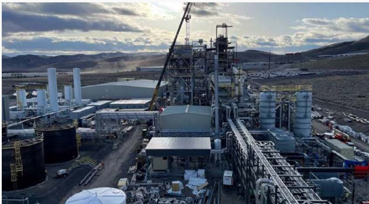
► Abengoa continuó durante 2020 la construcción de la planta Sierra Biofuels para Fulcrum.
