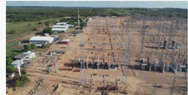
► La compañía se ha adjudicado la obra civil y montaje de la subestación de 500 kV Miracema.
