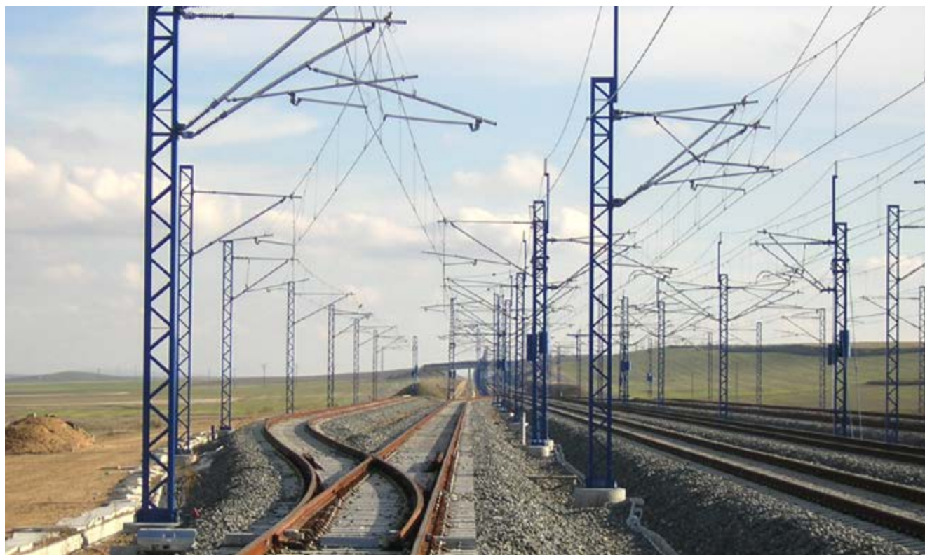
► El proyecto de innovación Alis confiere seguridad y eficiencia a los sistemas ferroviarios.
