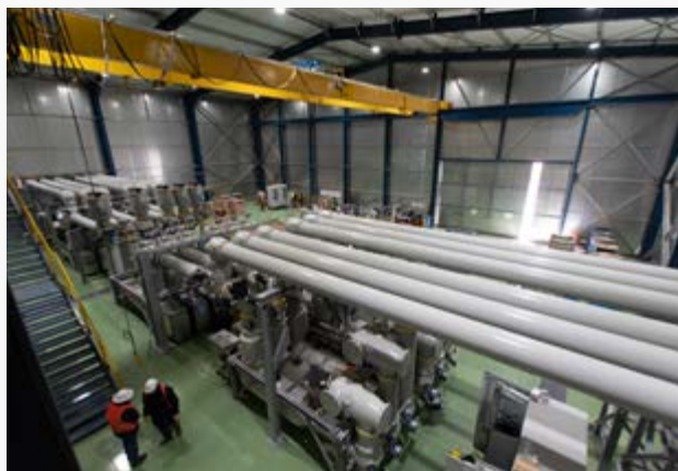
► La estación de seccionamiento Altiplano de 345 kV, con tecnología AIS y GIS y diseños específicos por estar ubicada a 4.000 msnm, entró en operación en el año 2020.
