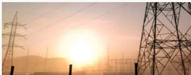
► Línea de 220 kV construida por Abengoa para Arauco en su proyecto MAPA.
