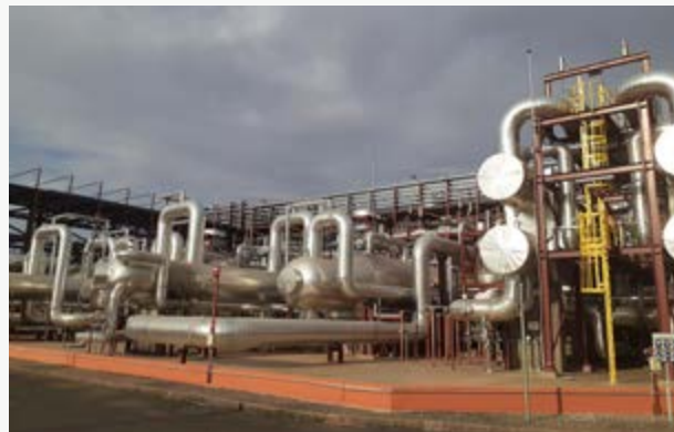
► Generador de vapor solar de Kasi Solar One.
