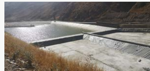
► Dique de retención de 30.000 m 3 de capacidad de embalse realizado por Abengoa para la mina Cuajone.
