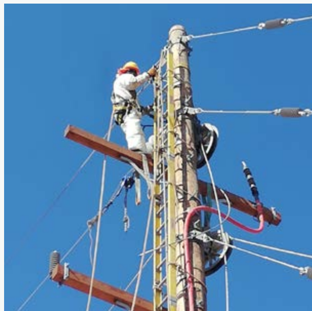
► Trabajos en la línea de distribución del proyecto minero Minas Justa de Marcobre.
