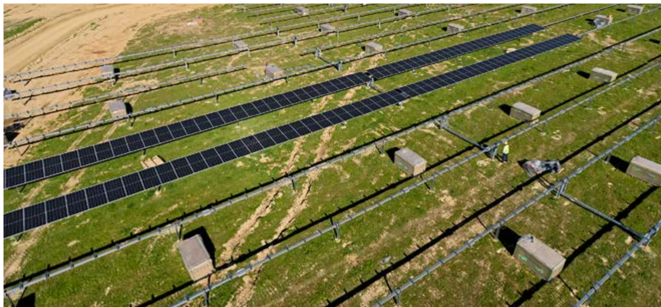
► Abengoa y FCC construyen el mayor proyecto fotovoltaico de Europa en Cáceres (España).
