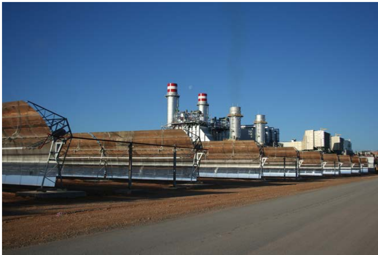
► En 2020 Abengoa ha firmado con la ONEE una nueva ampliación del contrato de O&M de la planta híbrida solar-gas de 472 MW, Ain Beni Mathar (Marruecos).
