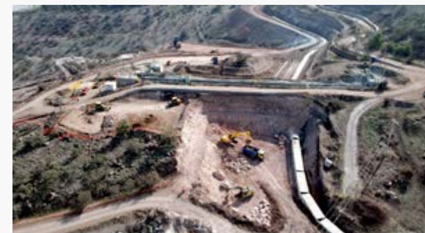
► Obras civiles en caminos, cercas eléctricas, tendido y cambio de tuberías del transporte para Codelco en la división Andina.
