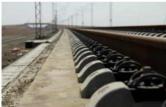
► Los proyectos de detección y localización de roturas de carril como los que desarrolla Abengoa son vitales para la seguridad de las personas.
