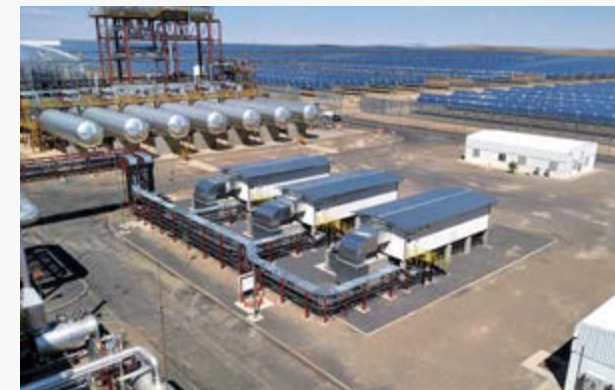
► Contenedores para los nuevos variadores de frecuencia de Kasi Solar One.
