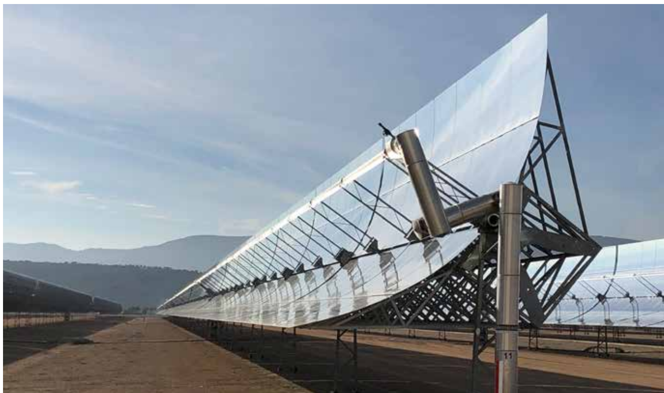
► La vertical de Servicios de Abengoa se ha adjudicado en 2019 las tareas de operación y mantenimiento de la planta termosolar de colectores cilindroparabólicos de Termollano, en Puertollano (Ciudad Real).
