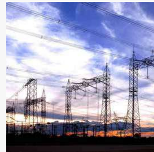
► Subestación de 500 kV en Brasil.
