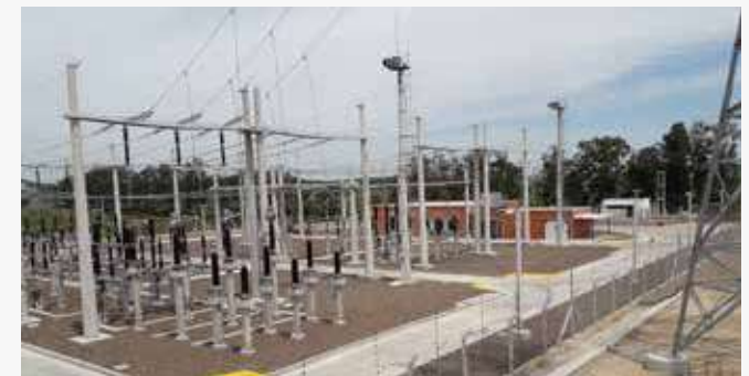
► Estación Tacuarembó B con una capacidad de 150 kV.
