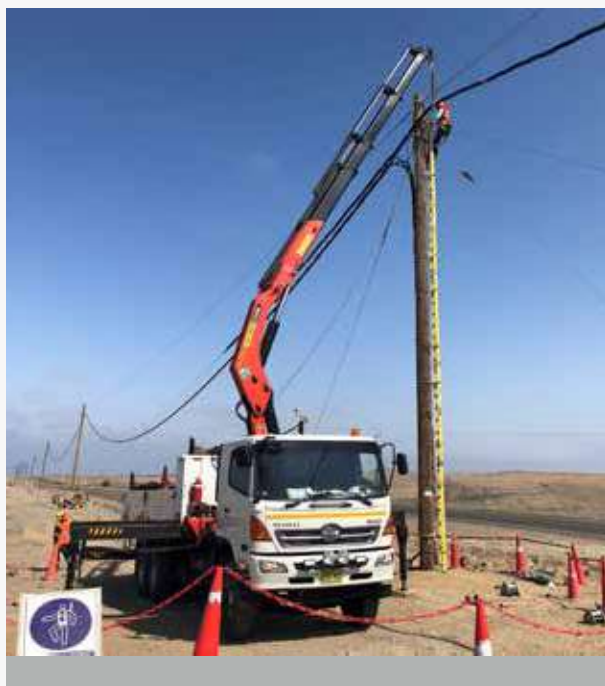
► Proyecto de línea de transmisión desde el puerto de Marcobre hasta la subestación de Mina Justa para Techint.
