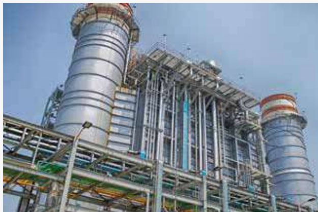
► Planta de cogeneración eficiente de 220 MW A3T.
