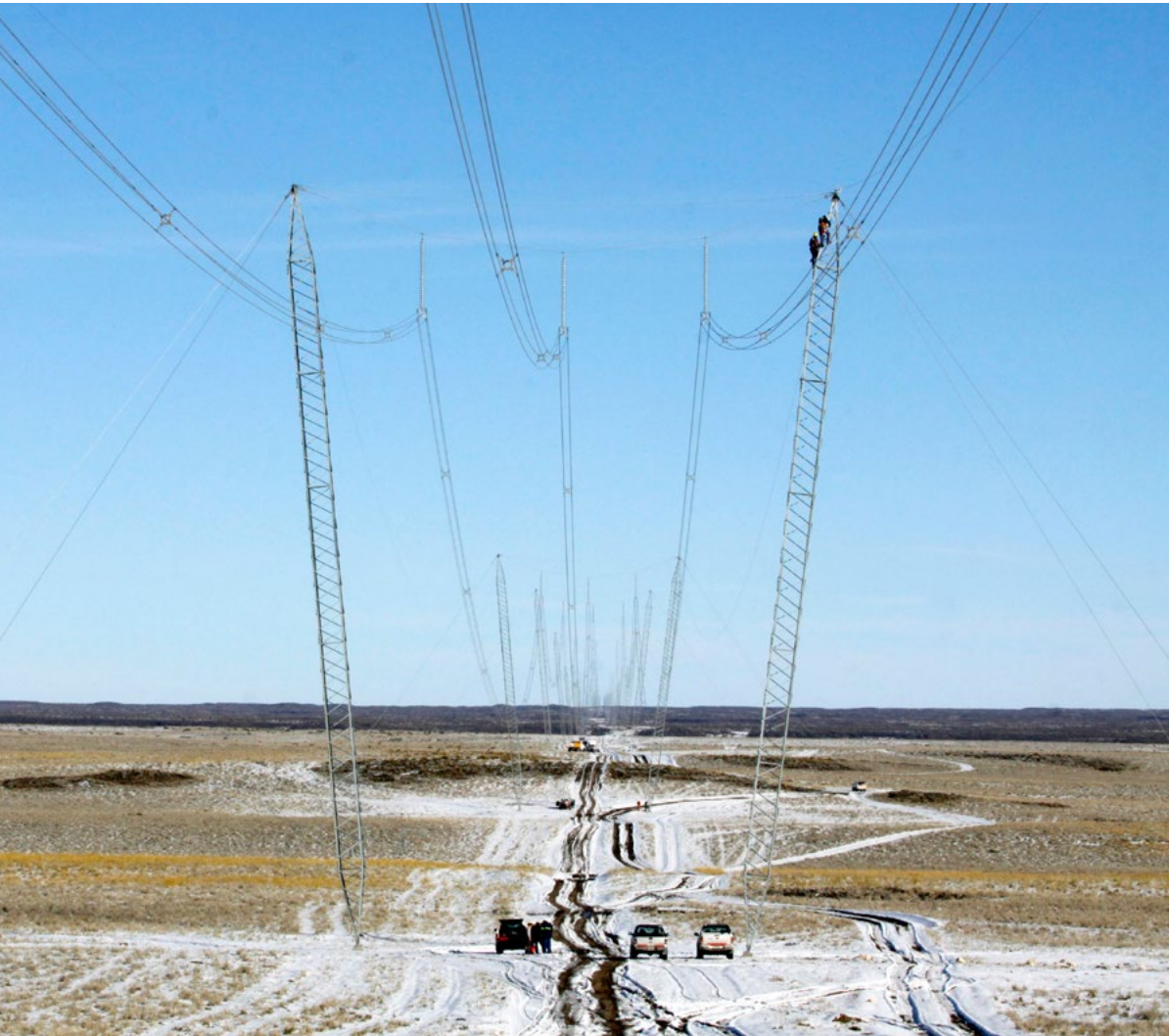
Línea de transmisión en Argentina, país donde Abengoa construyó su primera línea de transmisión en el exterior
