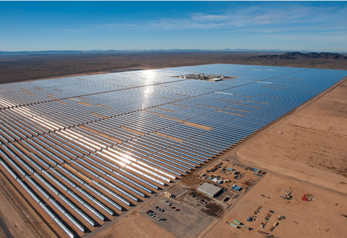
Solana, con una capacidad instalada de 280 MW, es la planta cilindroparabólica más grande del mundo
