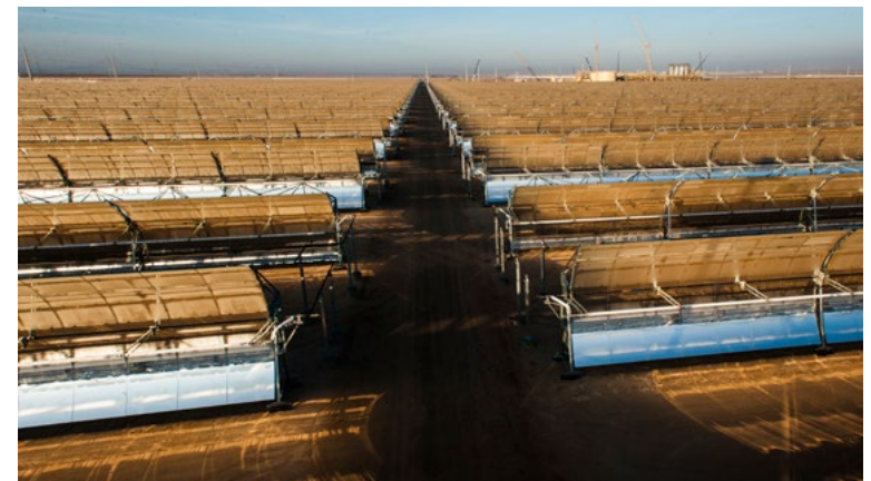
Las nuevas dimensiones y propiedades de los colectores y espejos de Mojave consiguen mejores rendimientos de potencia neta generada y una vida útil mayor
