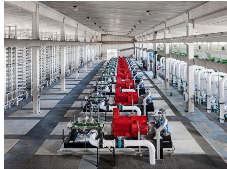
Planta desaladora de Cartagena (España), con una capacidad de 65.000 m 3 /día y en operación desde 2005
